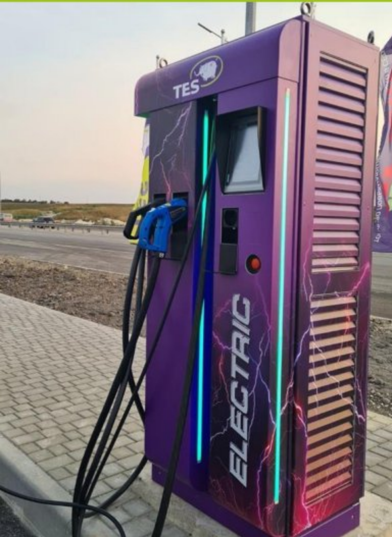
Вид ЭЗС: DC, 150 кВт Марка: KOSTAD Объект: сеть АЗС ТЕС, г. Симферополь
